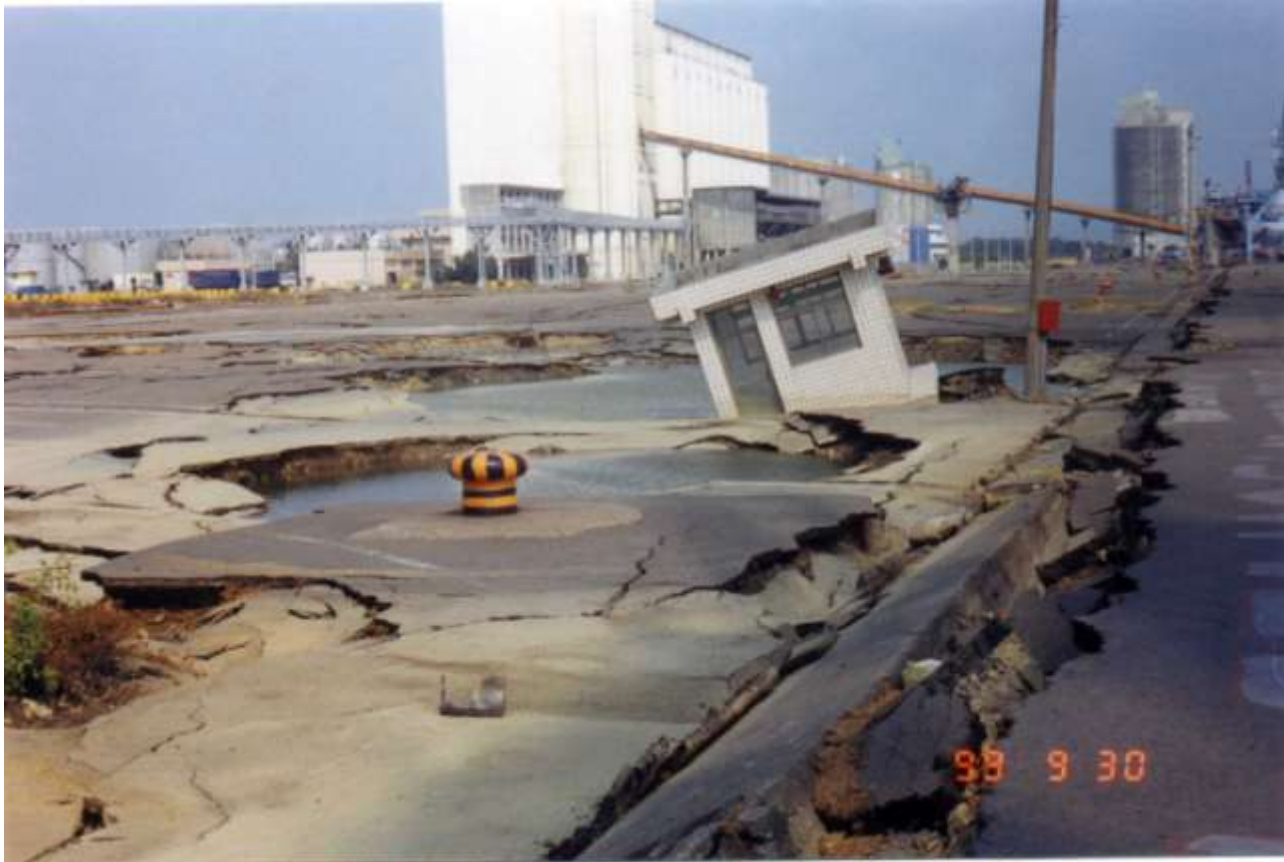
地震造成之碼頭地面扭曲移位破損 (中央大學土木系)
