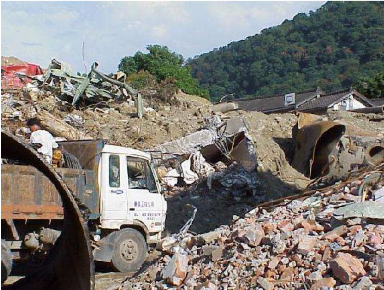
地震造成之輸水管線設施災變照片
