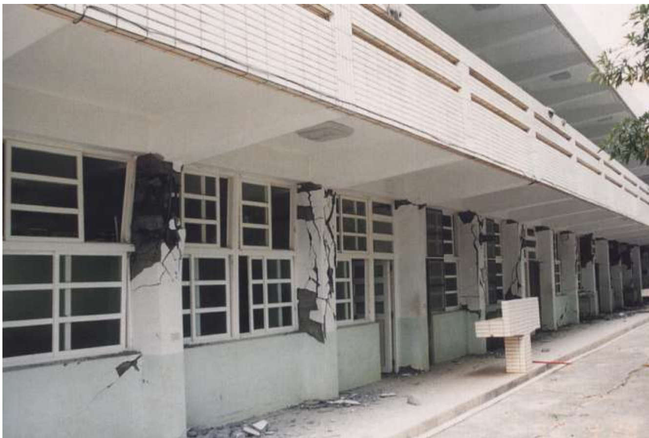
地震造成之房屋建築局部破壞災變照片 (土木工程技術地震叢書I)
