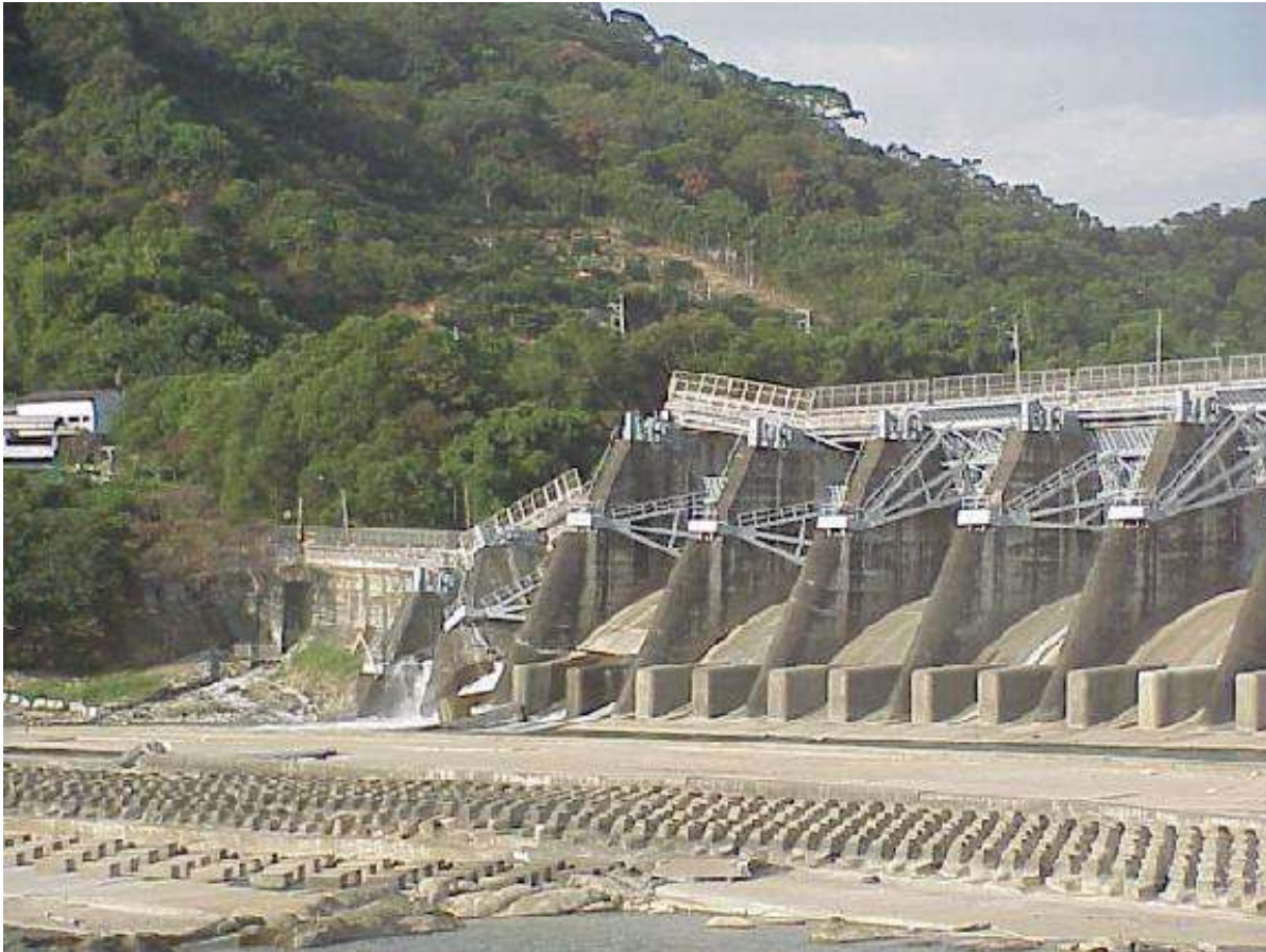
地震造成之水庫設施災變照片 (中央大學土木系)
