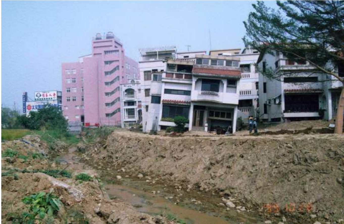
地震造成之房屋建築傾斜災變照片 (中央大學土木系黃俊鴻)
