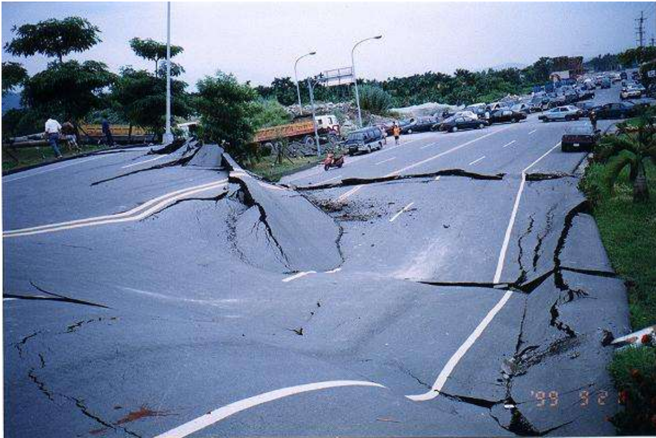
地震造成之道路破損災變照片 (中央大學土木系)
