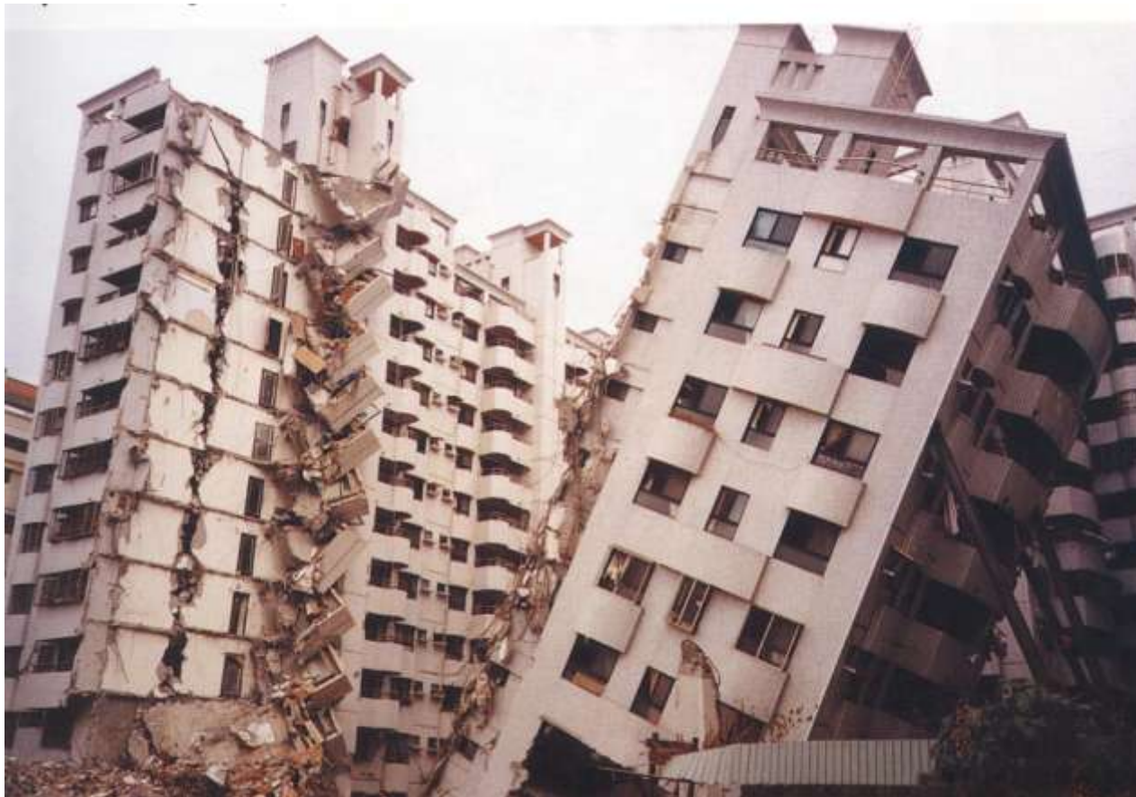
地震造成之房屋建築整棟傾倒災變照片 (土木工程技術地震叢書I)
