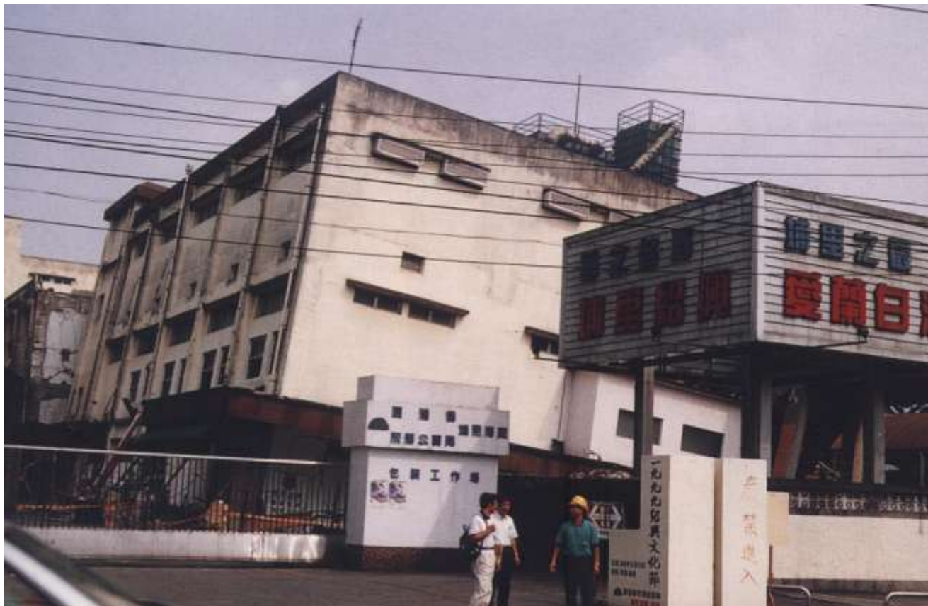
地震造成之房屋建築傾斜災變照片 (土木工程技術地震叢書II)
