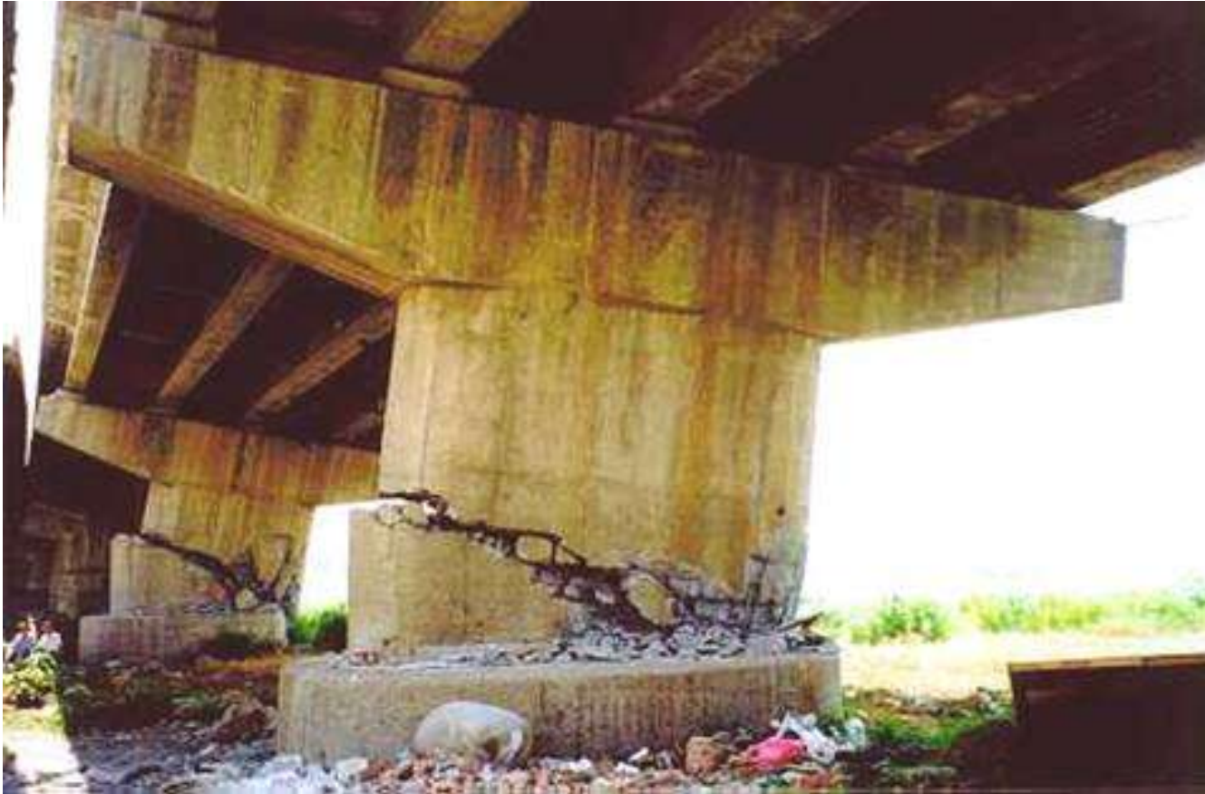
地震造成之橋樑橋墩破損災變 (中央大學土木系)
