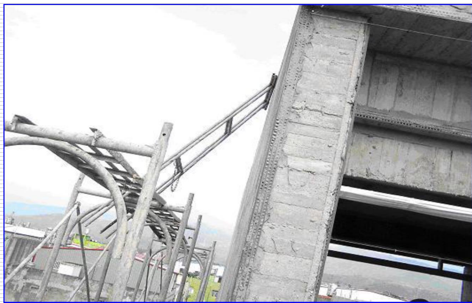
照片11 施工架上違規設置梯子當上下設備
