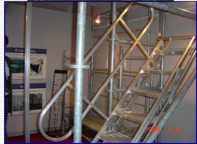
照片2 上下設備樓梯應有適當護欄(得採足以防護工作者墜落之上拉桿等設備固定於上端交叉拉桿扣釘之方式代替)
