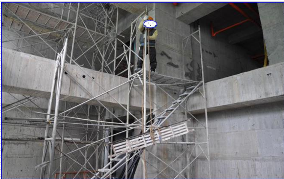
照片13 施工架拆除作業，使用繩索並以立架為支點，以人力吊運整捆構材(例如立架、交叉拉桿及下拉桿等)，立架及腳柱接頭無法承受吊掛重量，易造成腳柱接頭彎折斷裂、人員墜落及吊掛物飛落等災害，該搬運方法如未經專任工程人員確認安全性者，應予避免。
