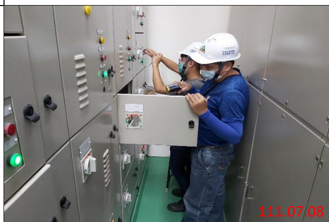
電氣設備檢查
