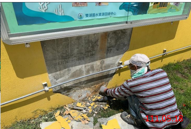
放流牆壁滲水查修
