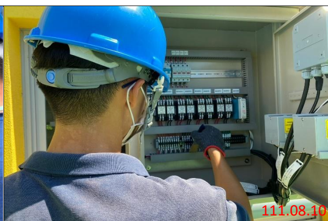
預防維護-配電盤清潔
