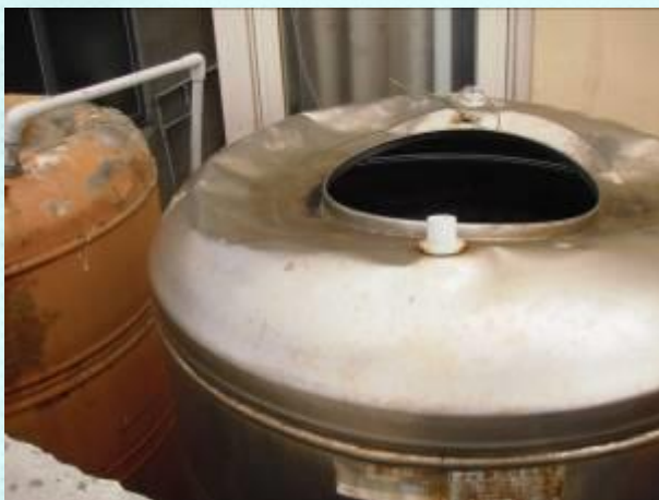
頂樓未加蓋水塔
