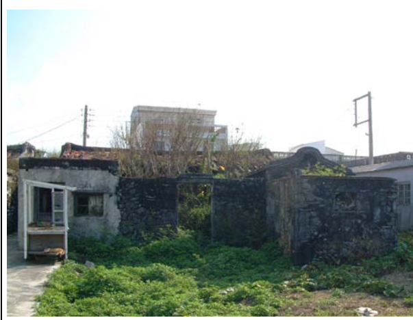
照片 5：傳統建築區內失修之傳統建築
