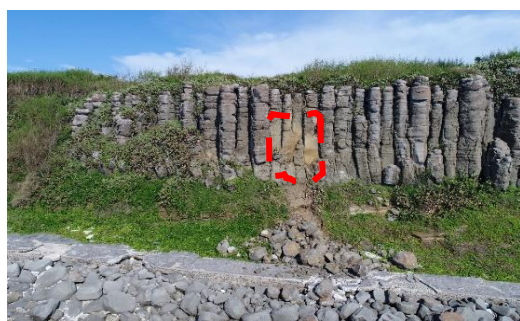
圖 31 8 月一場強降雨後發生的崩塌，紅色框為崩塌的範圍
