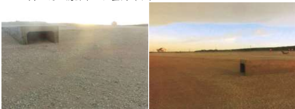
圖 69. 排水口被砂矜淤積的現象（澎湖縣政府農漁局提供）
