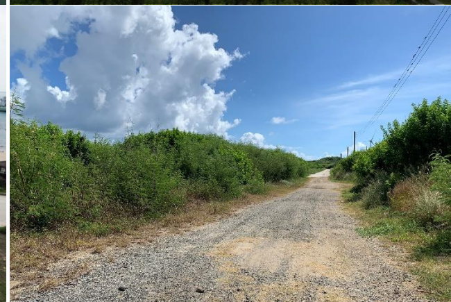
既有車道破損
