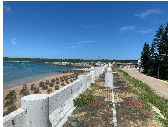
●海堤步道部分破損
