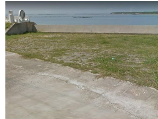
●道路鋪面需重新修繕
