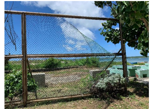
●圍籬設施破損
