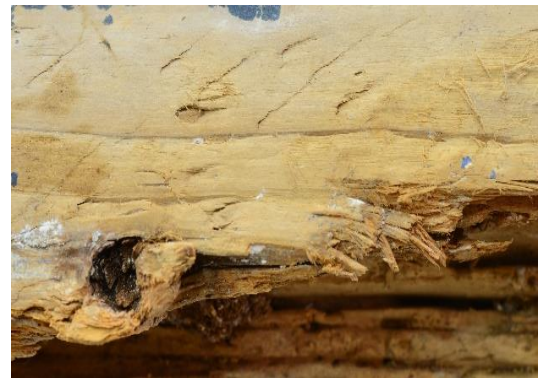
照片 4. 彩繪邊框部位之白蟻蛀蝕孔洞
